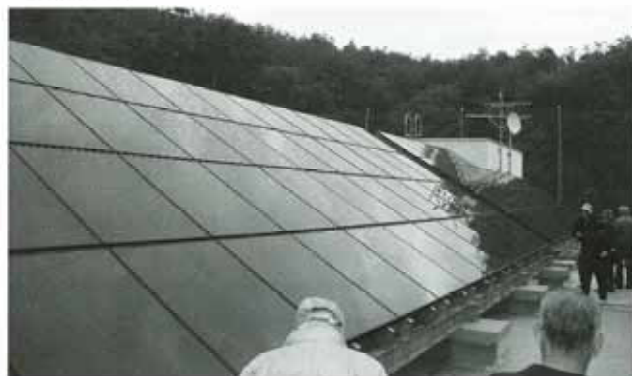
藤の園の屋上に設置した太陽光発電パネル
