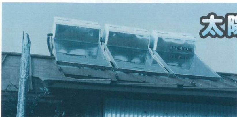
平成2年設置 自然循環式
