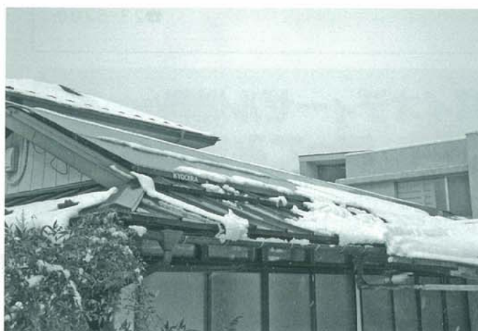
※積雪によって発電量が低下している状態
