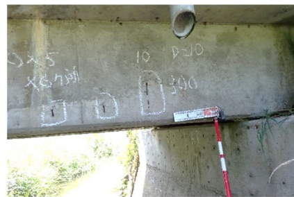
主桁の剥離・鉄筋露出
