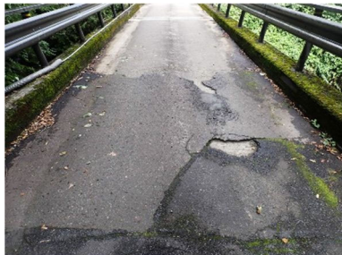
写真-3.5 路面の凹凸
