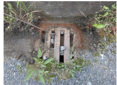
写真-3.7 排水施設の土砂詰まり
